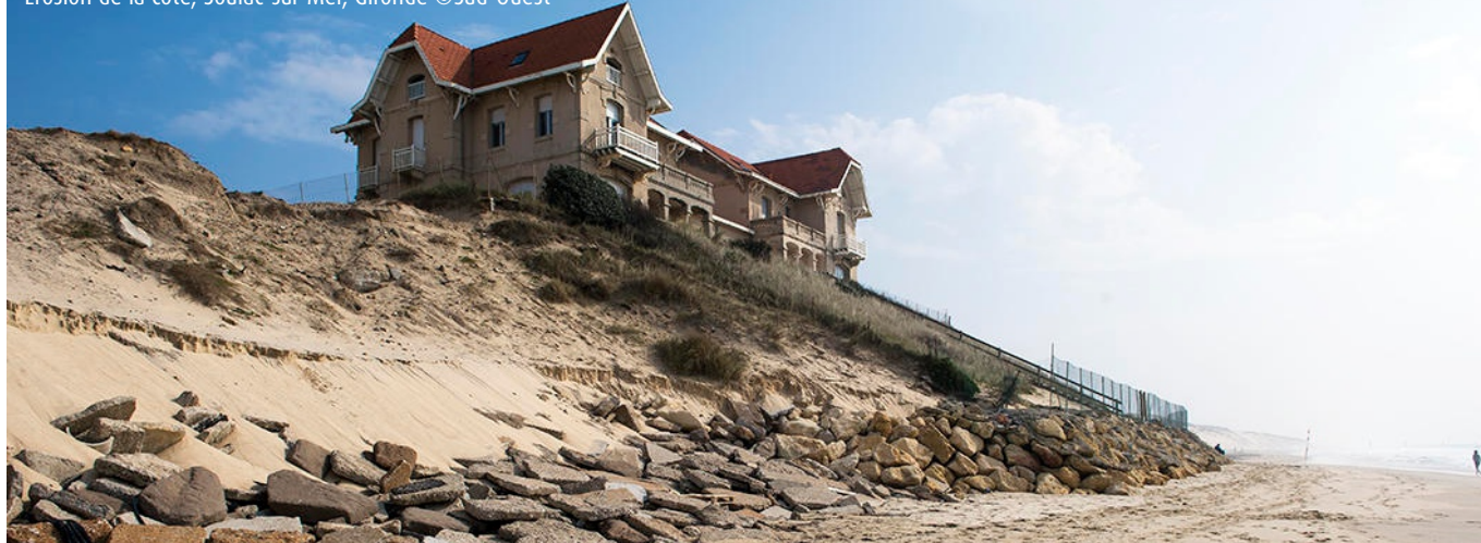
Érosion de la côte, Soulac-sur-Mer, Gironde ©Sud-Ouest
